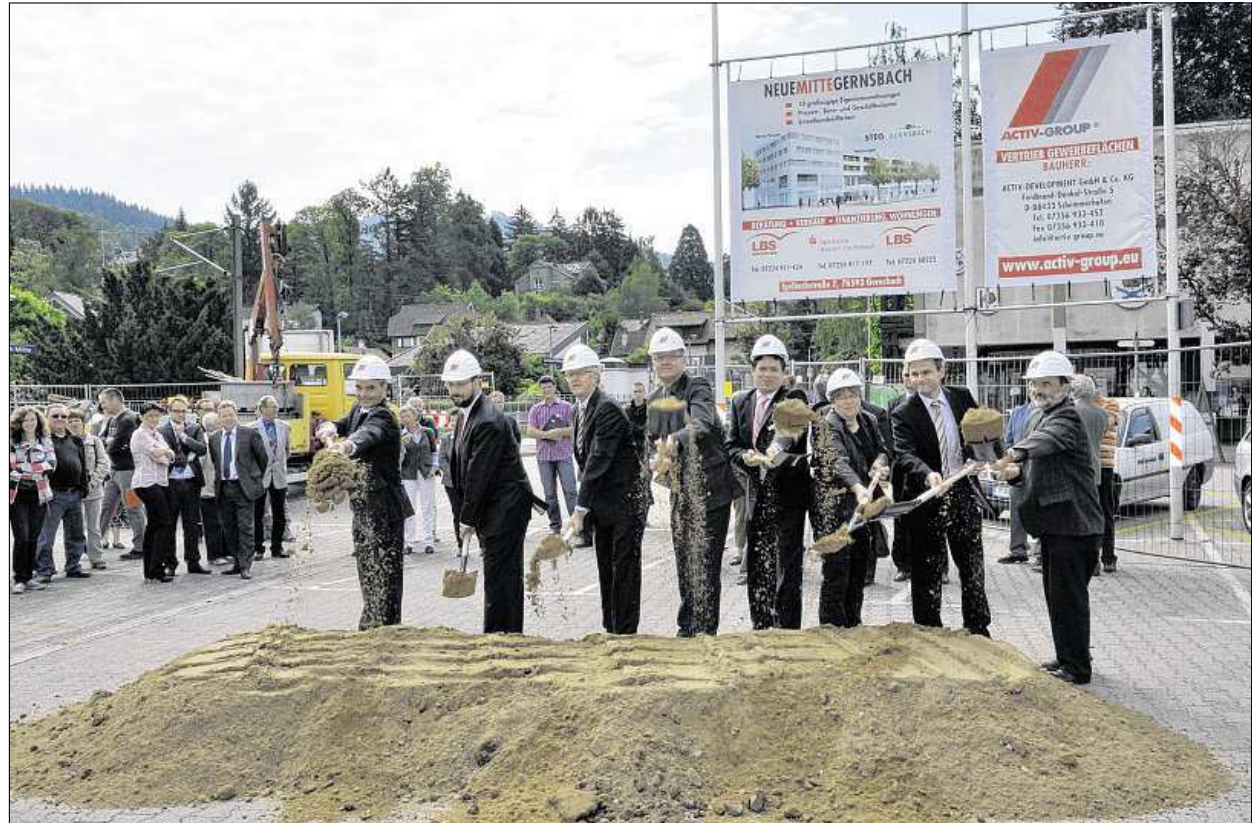
NACH 21 JAHREN DISKUSSIONS- UND PLANUNGSPHASE flog in der „neuen“ Gernsbacher Innenstadt gestern der Sand beim symbolischen ersten Spatenstich für das neue Wohn- und Geschäftshaus. Die Belegungsquote liegt momentan bei 70 Prozent.
